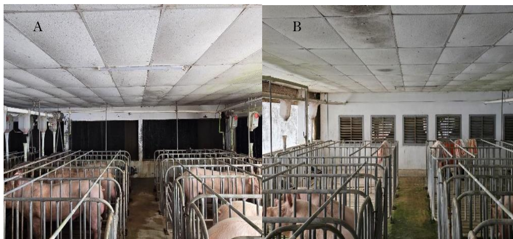
Figura 2. Instalaciones con ambiente controlado mediante el sistema de pared húmeda (A) y ventiladores (B) para la productividad de los cerdos macho (verracos) en el trópico.
